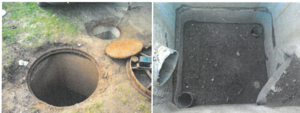
Figure 13 : regard du puisard existant en sortie du bassin d'assainissement routier
